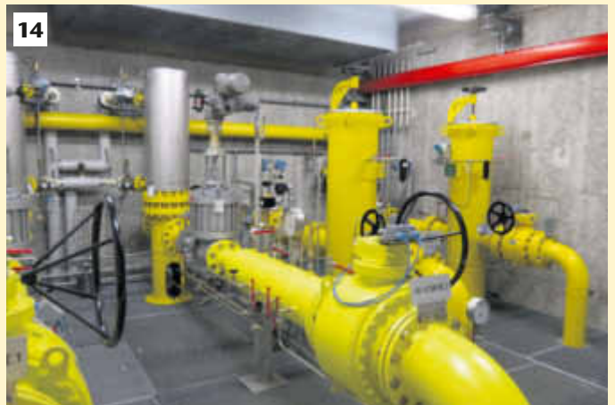
Druckreduzier- und Messstation der Erdgas Ostschweiz (Foto Kulturdetektive 2013).
