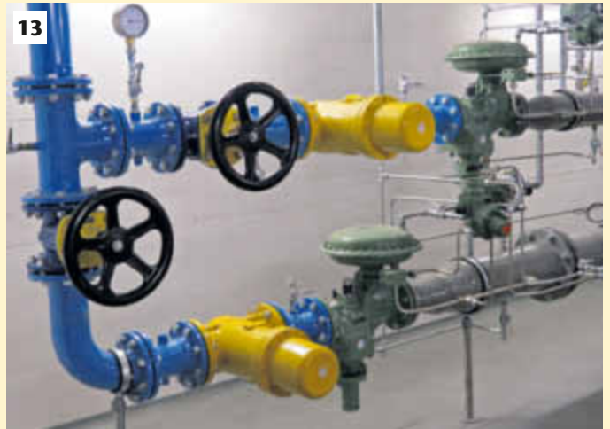
Blick in die Druckreduzier- und Messstation für Niederdruckeinspeisung ins Erdgasnetz von Wetzikon (Foto Kulturdetektive 2013).
