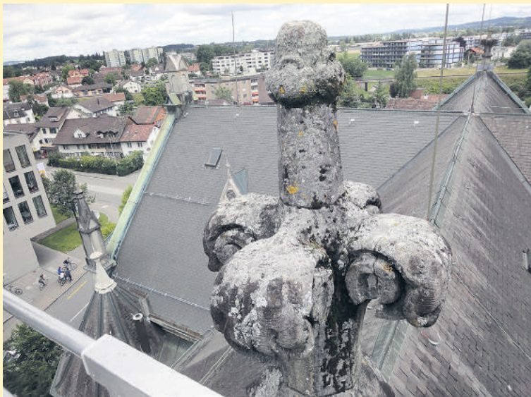
Die verwitterte Kreuzblume auf der Südseite musste ersetzt werden. (Beat Meier, 2017)
