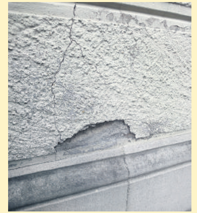
Typisches Schadensbild am Verputz im Sockelbereich. (Beat Meier, 2017)
