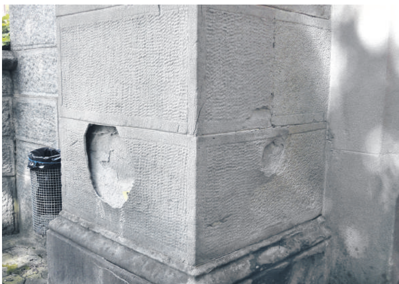
Schadensbild vor der Sanierung. (Beat Meier, 2017)
