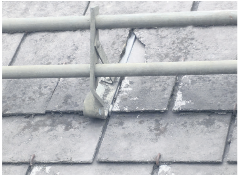
Starke Verwitterungsspuren auf den alten Dachflächen. (Beat Meier, 2017)
